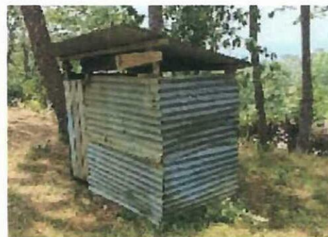
Foto 8: Las dos letrinas que usan los niños del nivel preprimario y primario del COPB Anexo a la Escuela Oficial Rural Mixta Chucutá La Unión están en mal estado.
